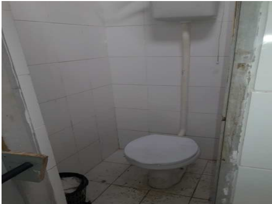
Figura 5 – Vaso sanitário I
