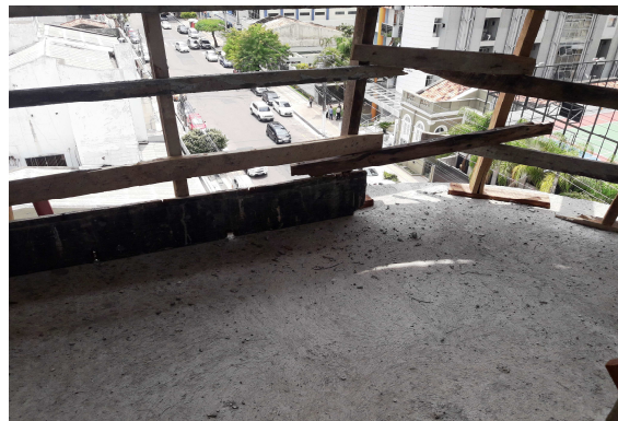
Figura 43 – Barreira de proteção
