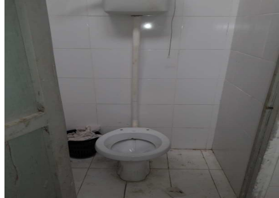
Figura 6 – Vaso sanitário II
