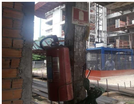
Figura 59 – Extintor de incêndio
