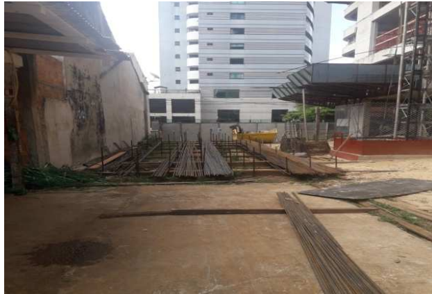
Figura 50 – Armazenagem (vergalhões de aço)
